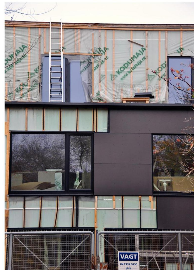
Projektet på Grøndalsvænge Allé i Københavns NV-kvarter bygger på præfabrikerede bokselementer fra det estiske firma Kodumaja, som satser stort på eksport til det nordiske byggemarked.
